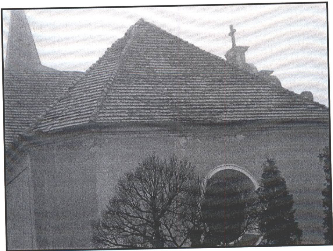
Fot. 20 Stan dachu, rynien i ścian bocznych strona zachodnia.
